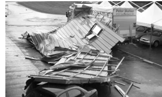
... «Dachschaden» durch eine Windhose 2006.
