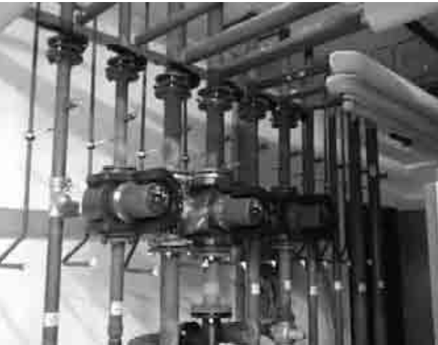
Ob sich die neue Heizverteilung auch wieder 40 Jahre hält?
