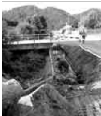
Baubeginn für den Radweg zwischen Balterswil und Itaslen: Entlang der Lützelzurmung werden Steinkörbe eingelegt
