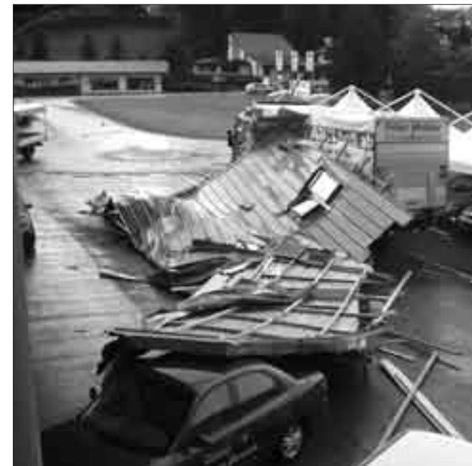
... lag zerstörerisch zerstört am Boden.
