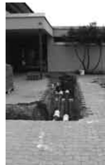
Der periferste Anschluss der Fernwärmeversorgung Balterswils: Das Schulzentrum Lützelburg wird zukünftig mit Fernwärme der Sägerei Brühwiler versorgt.
