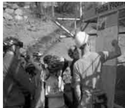
Bauführer, Pascal Müller, Fuchs Wohnbau erklärt den Verrohrungsplan, die Planung und den Einbau der Regenwassernutzungs-Anlage.
