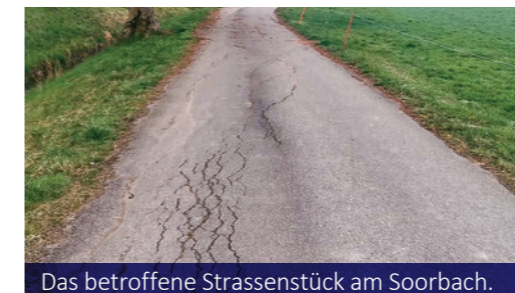
Das betroffene Strassenstück am Soorbach.
